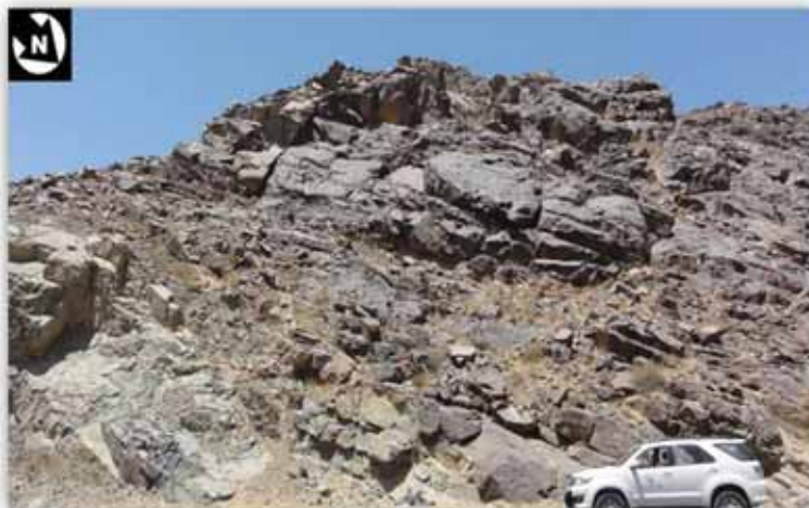
صورة توضح إحدى القطوعات الصخرية على طريق عقبة الخريطة وتوضح الكتل الصخرية المفككة والتي تمثل خطورة عالية في حال إنهيارها على الطريق
